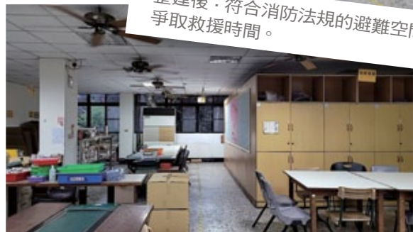
整建前：木作櫃子易燃物容易造成火場危機。
